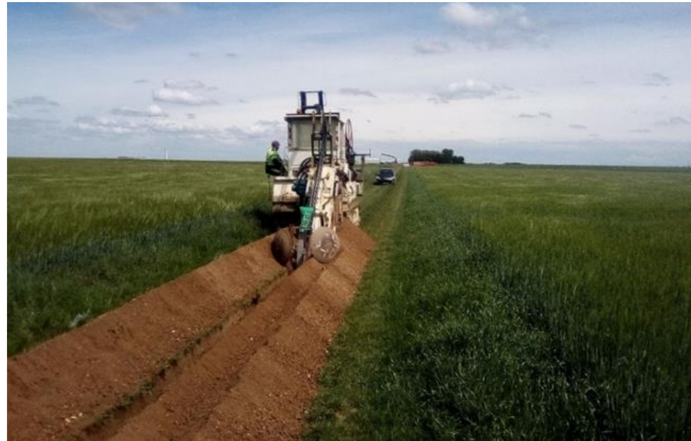
Photo 148 : tranchée pour le passage de réseau électrique HTA à partir d'une trancheuse (Source : VALOREM)
