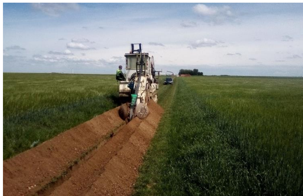
Photo 162 : pose d'un câble HTA à 1,20 m à partir d'une trancheuse (source VALOREM)
