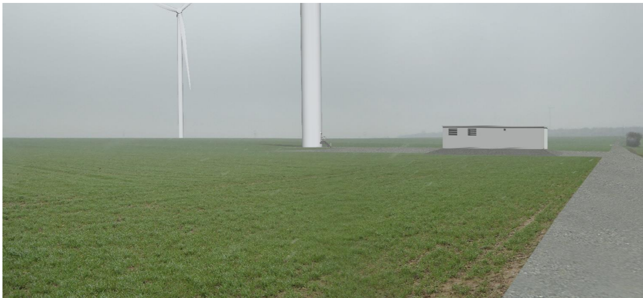
Figure 66 : photomontage du poste de livraison électrique du parc éolien de DIOU Énergies
